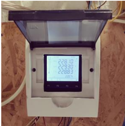
Рисунок 1. – Фото вимірювача PMAC770 Multifunction Power Meter, встановленого на вимірювальному стенді
