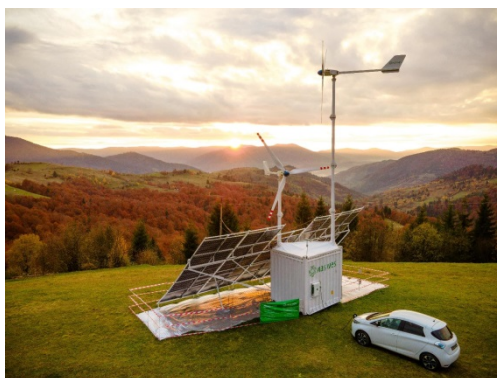
Рисунок 1 – Мобільна автономна сонячно-вітряна електростанція MASWES™ (20,5 кВт)
