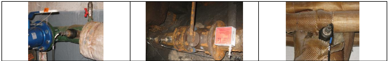
Рисунок 2 – Датчики реєстратора та акустичний випромінювач системи РАСТР-2В на трубопроводі теплової мережі
