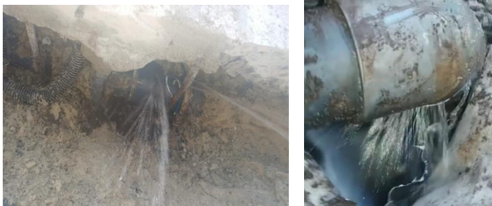
Рис.4 Виток з полімерного трубопровода фільтрації басейна
