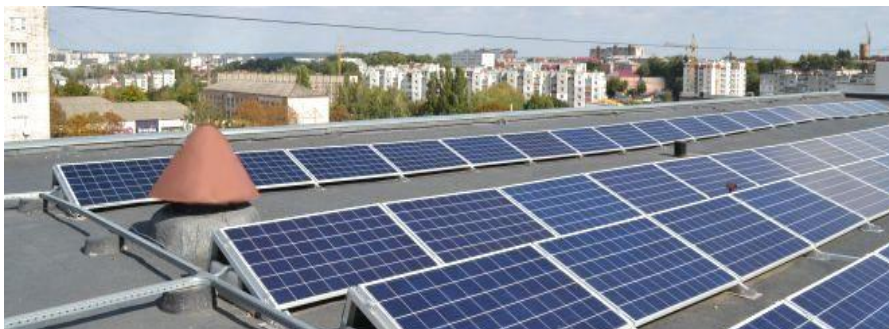
Рис. 1. Сонячна електростанція на даху четвертого корпусу ХНУ
