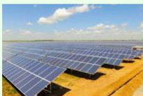
Solar PPt – 80 MW
